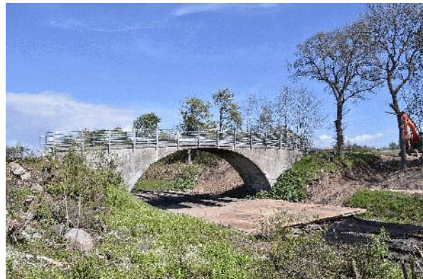
Vejbro i km 102,1, der skal fjernes.
